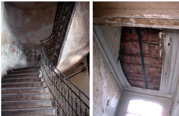
Figura 41: Vistas interiores del edificio San Fernando, 2008. A la izquierda se aprecia una de las escaleras principales que conduce a los apartamentos, los escalones son piezas monolíticas de terrazo; a la derecha se ve a través del plafón de manta de cielo la estructura del sistema de entrepisos, el cual se denomina “Guastaviano” y representa una evolución tecnológica de la más conocida “bóveda catalana”.
