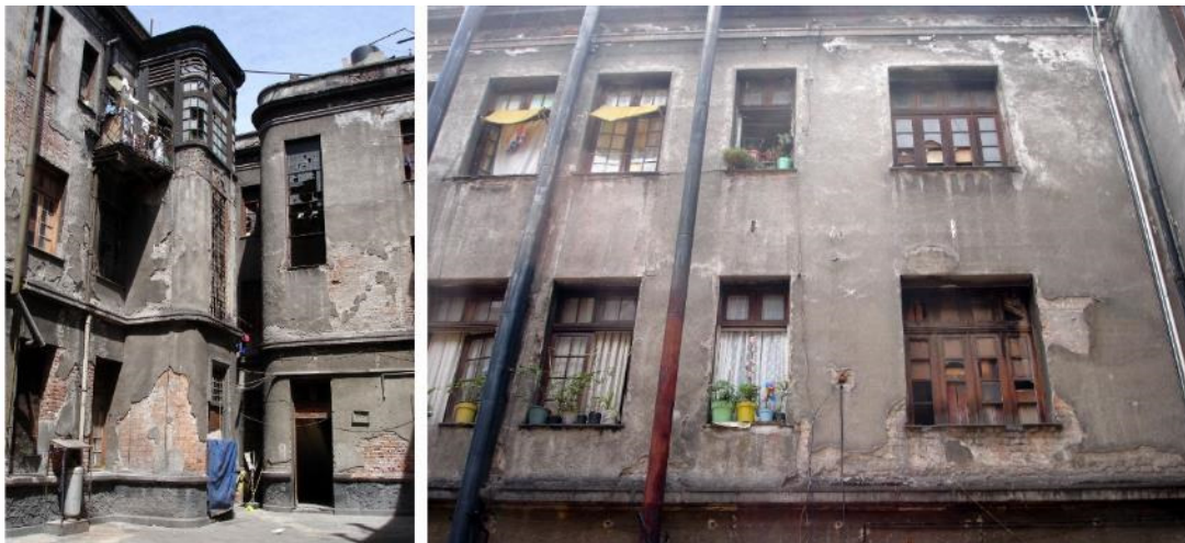
Figura 40: Vistas de los patios interiores del edificio San Fernando, 2008. En la foto de la izquierda se aprecian las escaleras como volúmenes independientes; en la foto derecha se aprecian la sucesión de ventanas, la primera del lado derecho y más grande es la que corresponde al comedor, después le sigue la del Pantry, y el par de la cocina.
