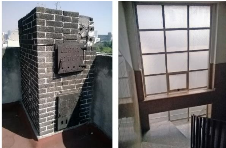
Figura 197: Par de vistas interiores del edificio ubicado en Ámsterdam núm.122, a la izquierda, detalle del incinerador de basura en la azotea, a la derecha, vista del cubo principal de escaleras
