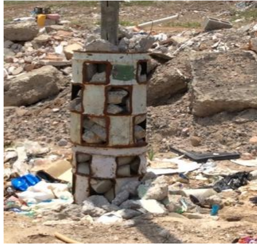
Figura 3.9 Pozo de extracción y quema de biogás Fuente: Proporcionada por Ing. Antonio Jacintos Nieves
