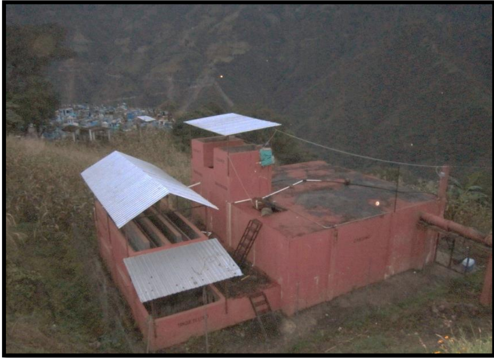
Figura 11. Infraestructura para tratar aguas residuales del barrio Guadalupe, Mazatlán Villa de Flores, Oaxaca.
