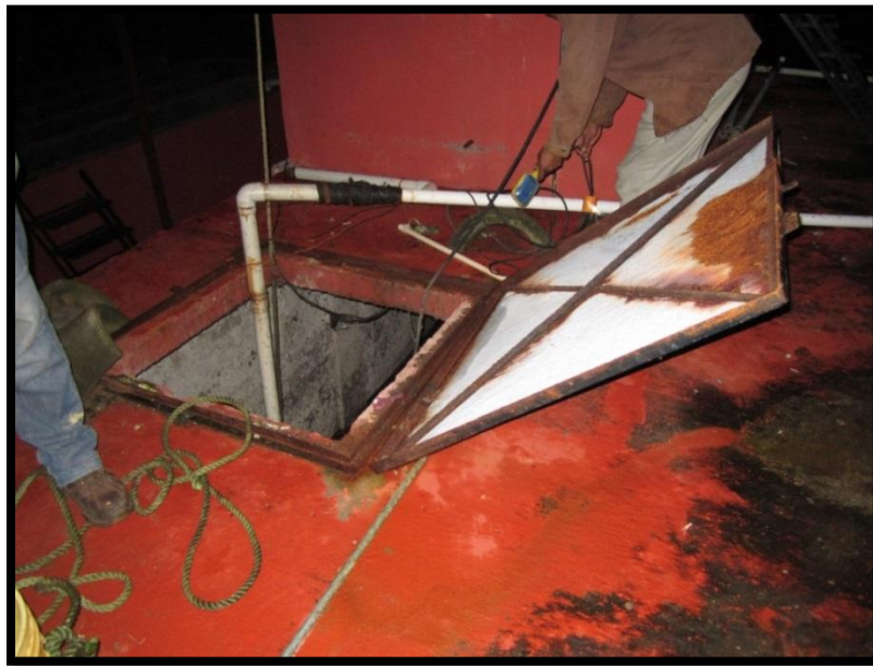
Figura 12. Ingreso del agua residual del barrio Guadalupe al cárcamo.
