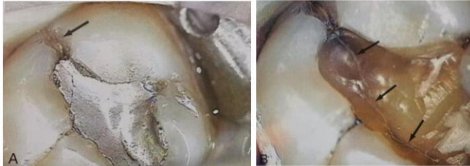
Fig. 31 Eliminación de restauración de amalgama que deja en evidencia fracturas en el piso de la cavidad.
