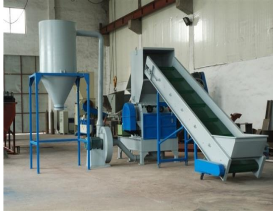
Fig. 22 Centro de secado ( http://www.maquinariadereciclaje.com ).
