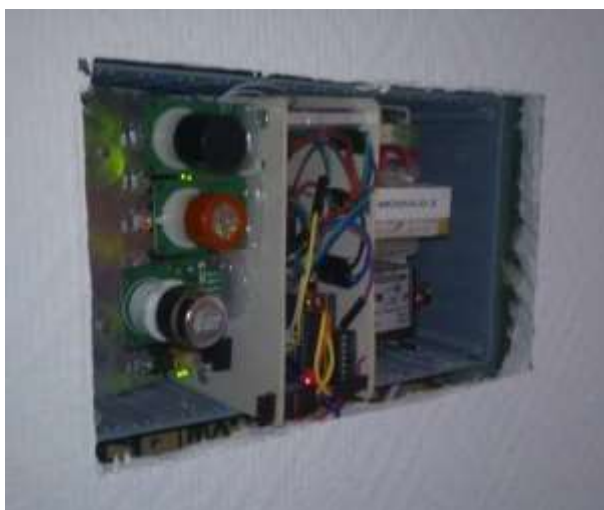
Fig. 119. Módulo de monitoreo instalado en el muro.
