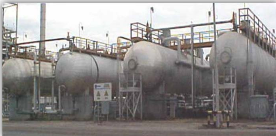
Figura 5-14. Equipo de desalación, 2007.
