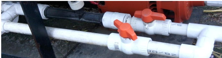
(b) Válvulas del sistema Venturi y bypass del mismo
