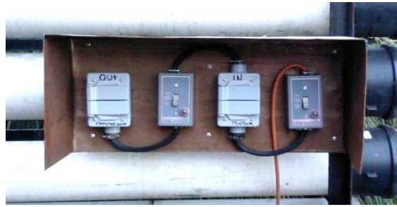
Figura 4.13 Panel de controles eléctricos
