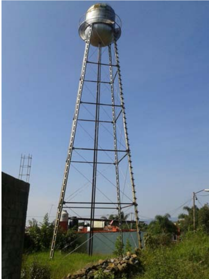
Fotografía. 3.6 Se muestra el tanque elevado donde llega el agua después de ser bombeada del cárcamo de la fotografía anterior. El cual se encuentra en la parte más alta para así distribuir a la zona de proyecto.
