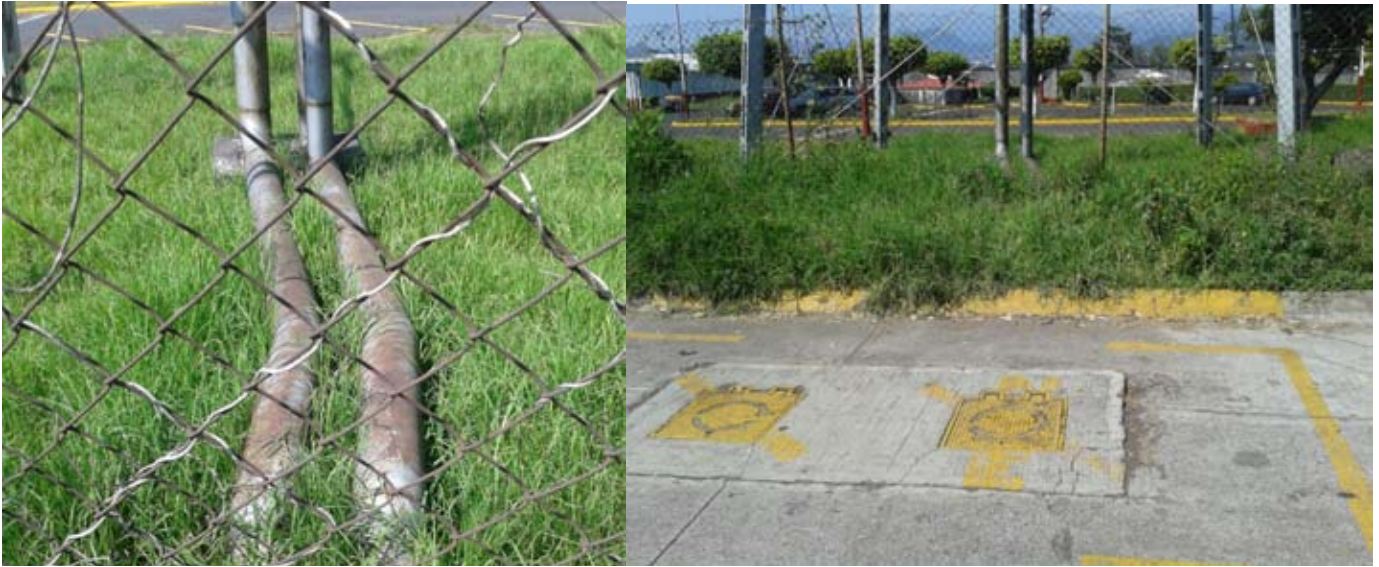
Fotografía. 3.2.- Condiciones en las que opera la tubería (Imagen de la izquierda) y las cajas de válvulas (imagen de la derecha).
