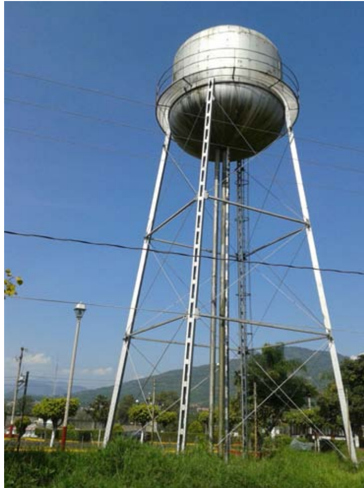
Fotografía. 3.1 Tanque elevado que surte la línea de conducción a revisar.
