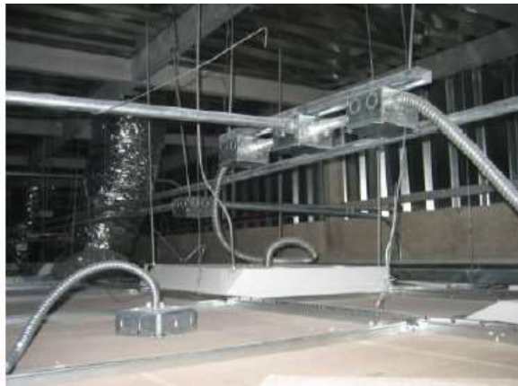
Figura 1.2 Instalación eléctrica parcialmente oculta
