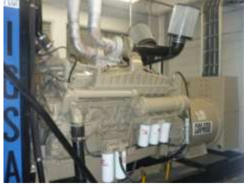
Figura 1.3 Planta de Emergencia
