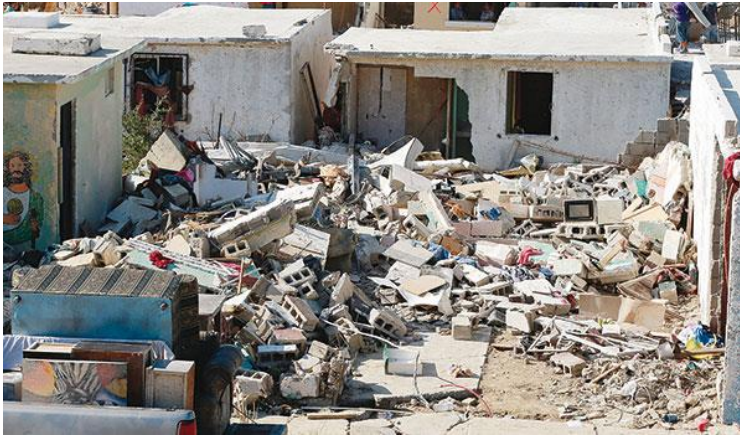
Fotografía 1. Viviendas destruidas tras el tornado en Acuña, Coahuila.
