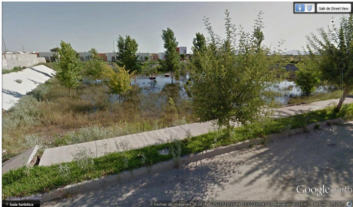
Fotografía 16. Parques inundados por falta de drenaje
