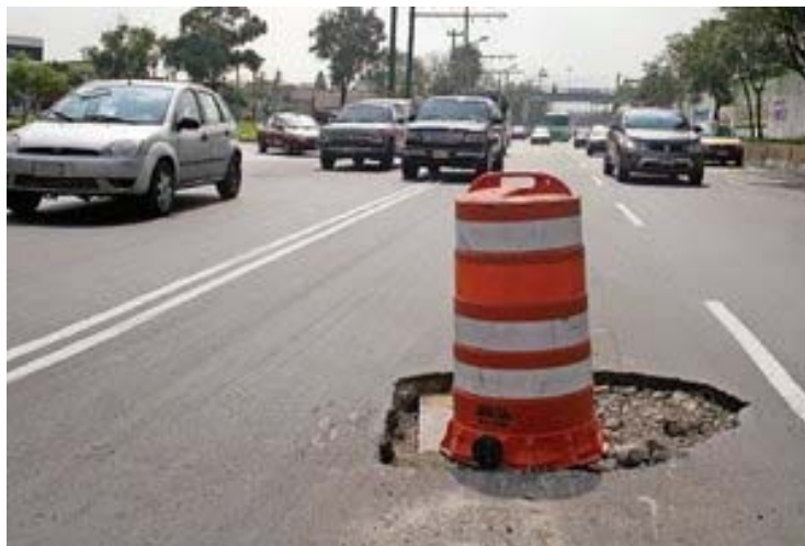
Figura 2.3 Falta de mantenimiento en vialidades
