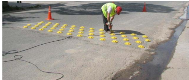
Figura 2.20 Reductores de velocidad
