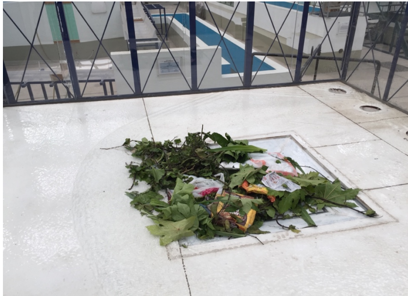
Figura 69 Boca de tormenta obstruida durante el ensayo experimental
