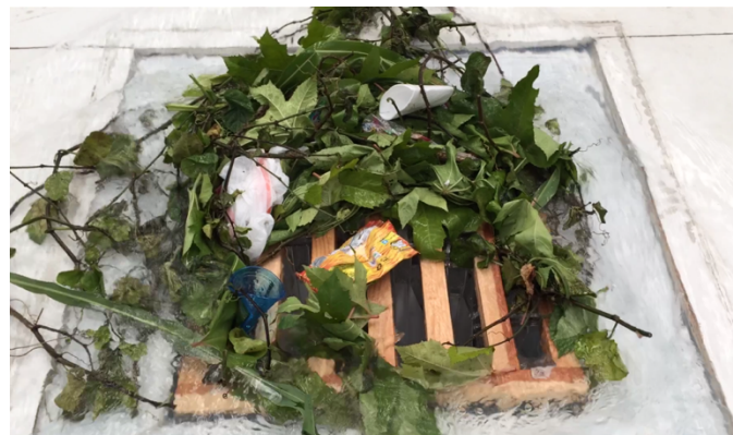
Figura 78 Problemática presentada en la boca de tormenta autolimpiable: obstrucción por ambos frentes
