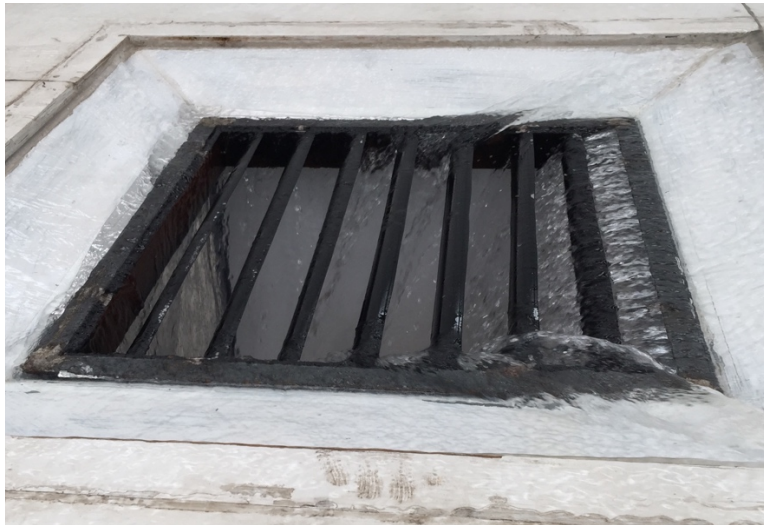
Figura 73 Flujo ingresando en la Rejilla de Barras en Veleta Curva
