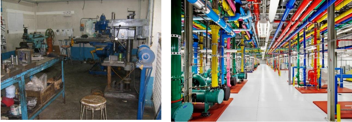
Figura 6. 9. Ejemplo de mejora continua en instalaciones
