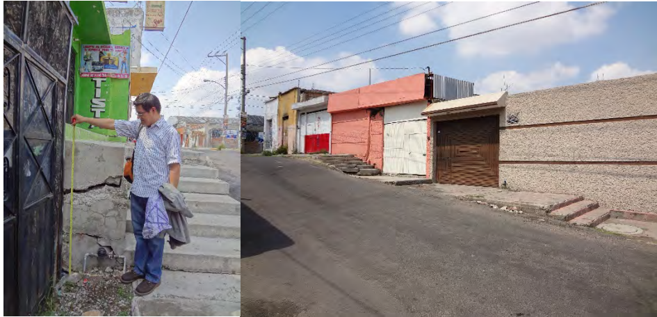
Fotografía 18 En la calle Francisco I. Madero se observa un desnivel más pronunciado de alrededor de 1.50 m se observan daños significativos en las bardas de las casa y la construcción de dos conjuntos de escalones.
