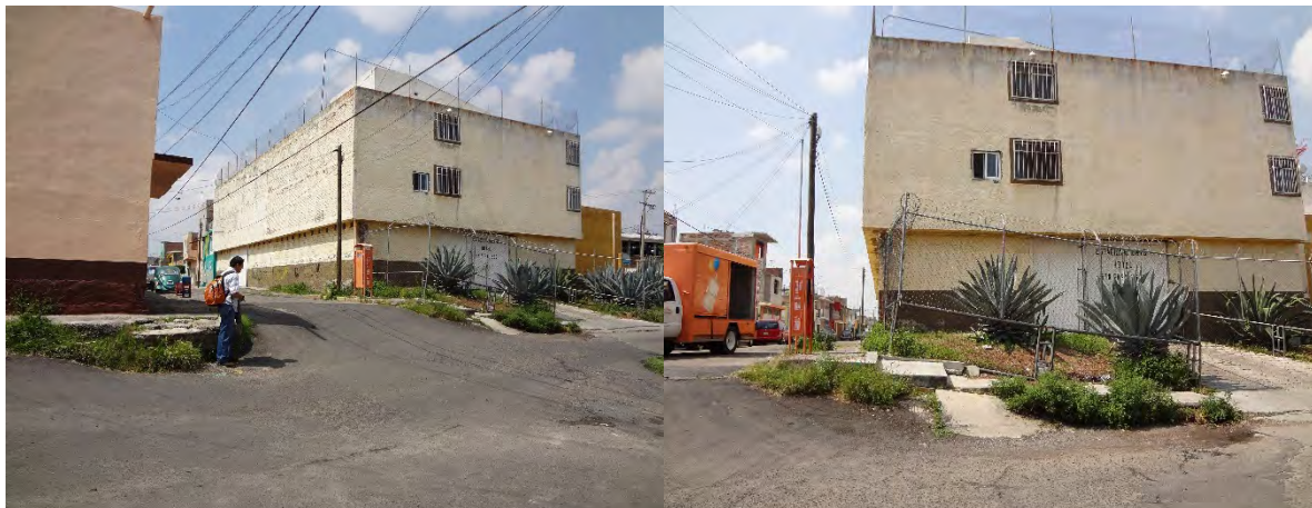
Fotografía 16 Esquina de las calles Plan de Ayutla norte, Avenallanal y Dolores María, desnivel de aproximadamente un metro con afectación en la carpeta asfáltica, banqueta y se observa también la afectación en ese edificio que se utiliza como hotel.
