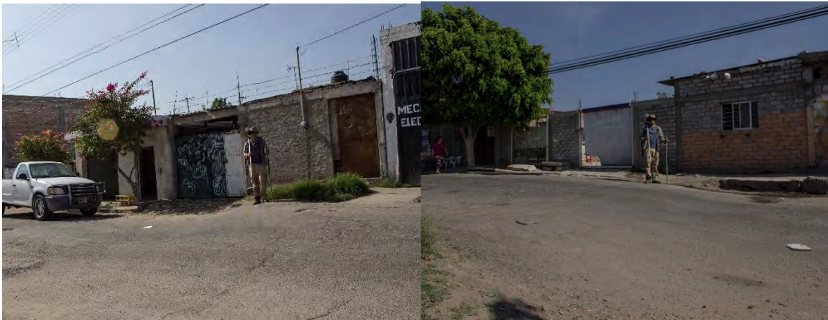
Fotografía 31 En la calle Plan de Cuernavaca se observa daños en las casa de la zona así con la un desnivel de menos de un metro sobre el pavimento.
