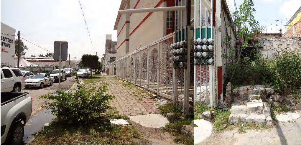
Fotografía 14 Calle Plan de Igual se observa un desnivel de aproximadamente 50 cm que afecta la carpeta asfáltica, la banqueta y se encuentra junto al edificio habitacional una casa totalmente destruidas.
