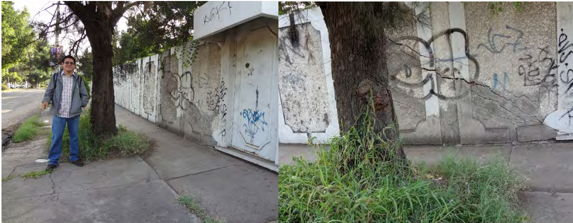
Fotografía 33 Sobre la calle Guillermo Prieto se observaron agrietamientos en las bardas y un pequeño desnivel en el pavimento y algunas pequeñas afectaciones sobre la acera.
