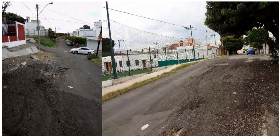
Fotografía 25 Calle 20 de noviembre esquina con Primo de Verdad y Ramos se distinguen daños sobre el pavimento de la calle Primo de verdad y en 20 de noviembre se observa un desnivel de 1.50 m. Además de agrietamientos que afectan las viviendas y bardas.
