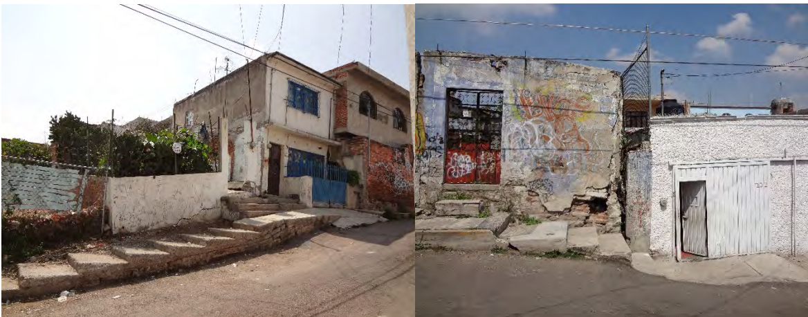
Fotografía 19 En la calle Acapulco se puede observar un desnivel de casi dos metros. Se ven al menos cuatro casas afectadas, una totalmente partida por la mitad, otra que sólo queda la barda de la construcción original y al parecer se encuentran ya deshabitadas.
