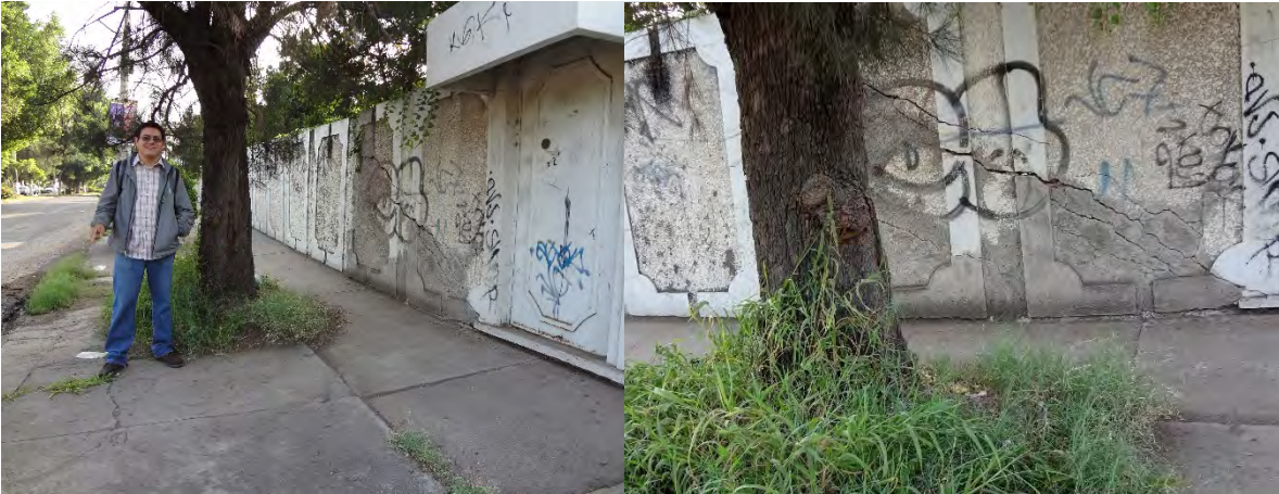
Fotografía 32 Sobre la calle Guillermo Prieto se observaron agrietamientos en las bardas y un pequeño desnivel en el pavimento y algunas pequeñas afectaciones sobre la acera.
