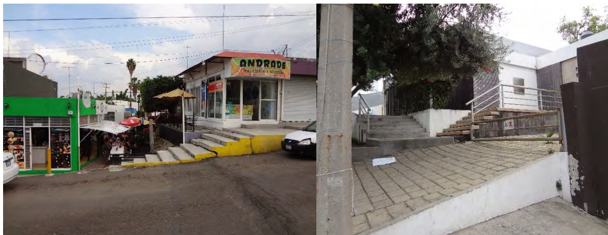
Fotografía 23 Sobre la calle Guillermo Prieto se observa negocios que fueron separados por el desnivel. Además de otros con grietas y la construcción de varios escalones.
