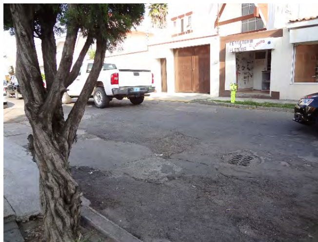
Fotografía 12 Calle Aguilar y Maya sólo se notada un pequeño daños en el pavimento y banqueta de la calle de entre unos 20 cm a 30 cm.
