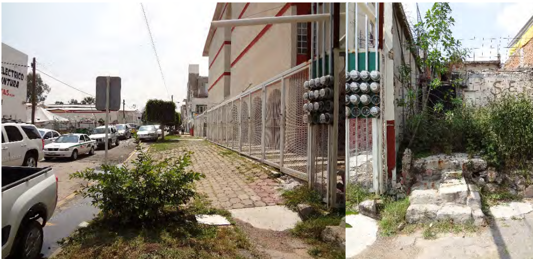
Fotografía 14 Calle Plan de Igual se observa un desnivel de aproximadamente 50 cm que afecta la carpeta asfáltica, la banqueta y se encuentra junto al edificio habitacional una casa totalmente destruidas.
