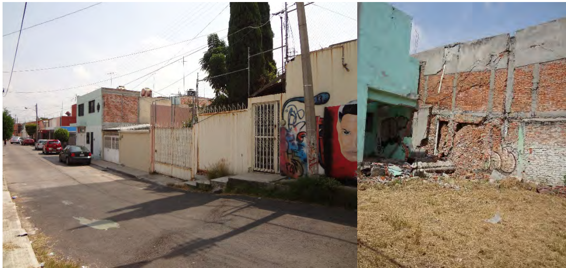
Fotografía 5 Sobre la calle Pedro de Gante también se pudo seguir el desnivel sobre la calle y los daños en una casa habitación la cual fue abandonada por el estado en el que se encuentra.
