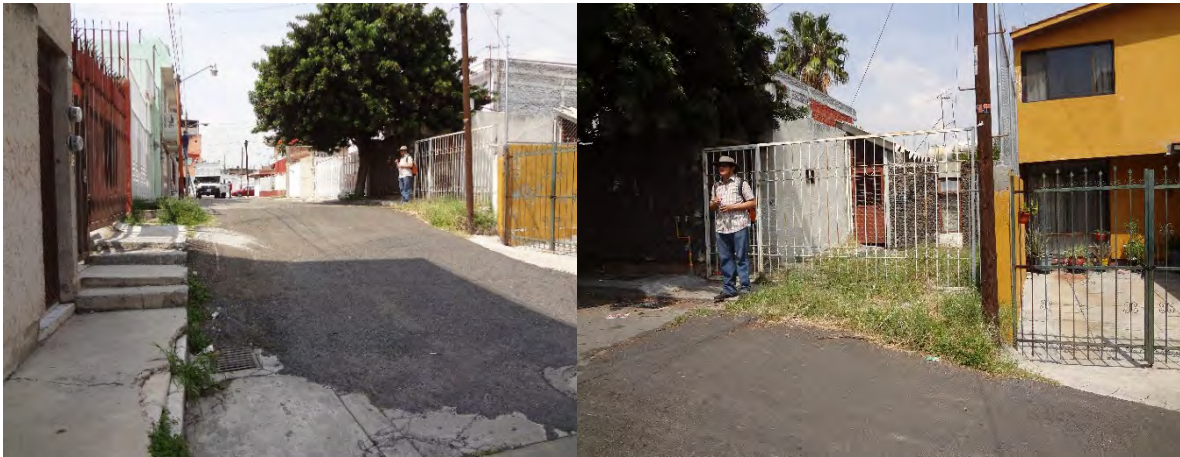
Fotografía 5 Calle Fray Toribio Motolinía evidente desnivel aproximadamente de un metro sobre la calle en la banqueta se observan cuatro escalones contruidos por este problema. Se ve también el cambio de nivel en las casas.
