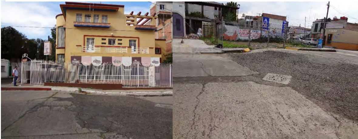
Fotografía 11 Esquina de las calles Guadalupe y La Paz se observa un desnivel de a aproximadamente 50 cm y algunos daños en el pavimento y banquetas.
