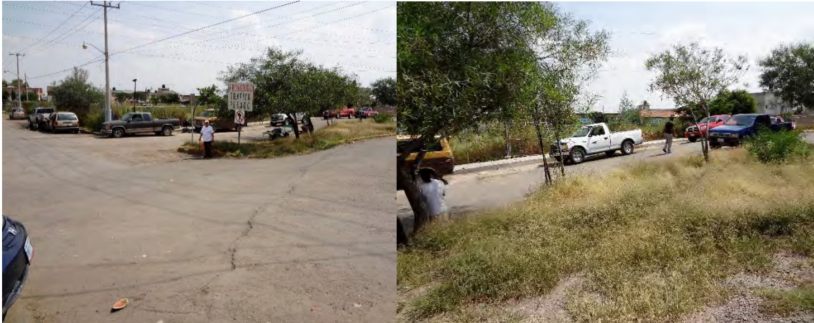
Fotografía 1 Calle Vasco de Quiroga en la parte sur de la ciudad, localizado detrás de la Central de Abastos. Se observa un claro desnivel que cruza la calle, afecta el camellón y también a la Av. Pase del Sol.
