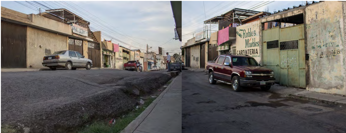
Fotografía 34 Se observa los daños sobre la calle Presa de la amistad el asfalto esta levantado del nivel de la acera de lado derecho de la calle y se observan daños sobre las casas en especial en la carpintería evidente en el zaguán.
