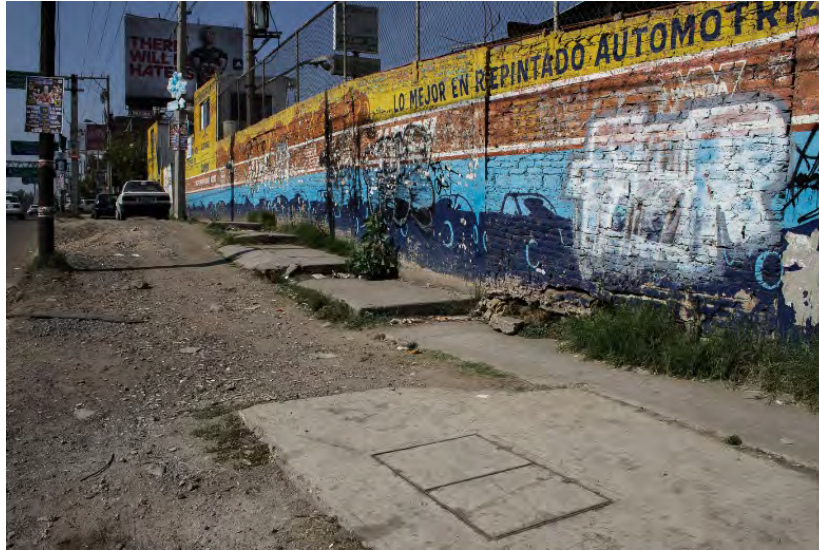
Fotografía 30 Sobre la Av. Tecnológico se observa un desnivel muy marcado al cruzar entre las calles Plan de Cuernavaca y Plan de Agua Prieta, se ven además daños en la acera, los escalones y las bardas de las propiedades de la zona.
