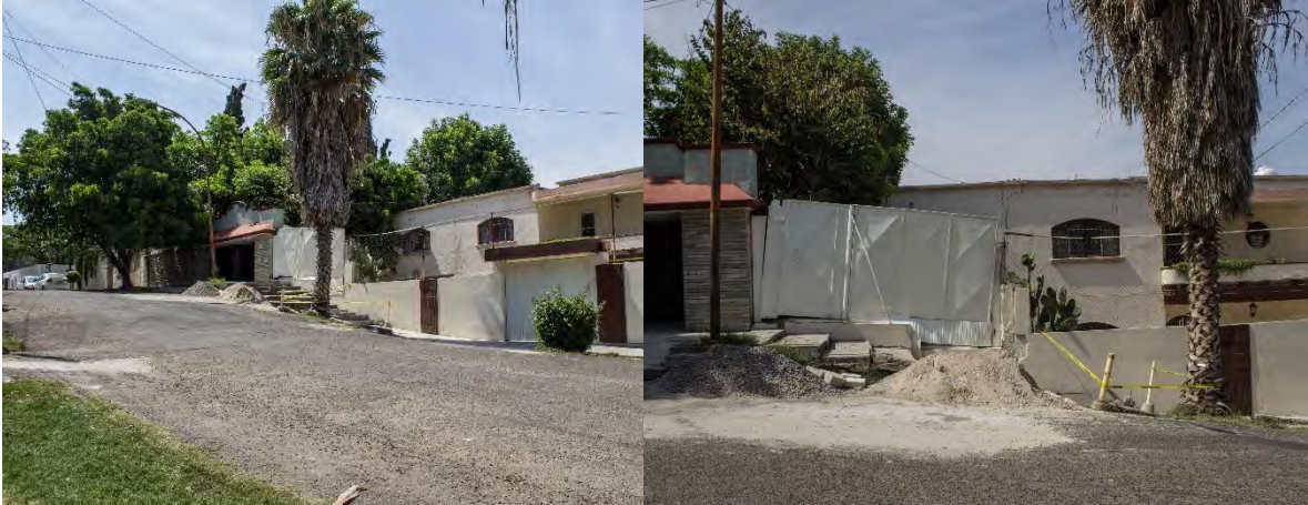
Fotografía 21 Calle Ignacio Manuel Altamirano se observa un desnivel de más de un metro, afectaciones tanto en el pavimento como en las casas.
