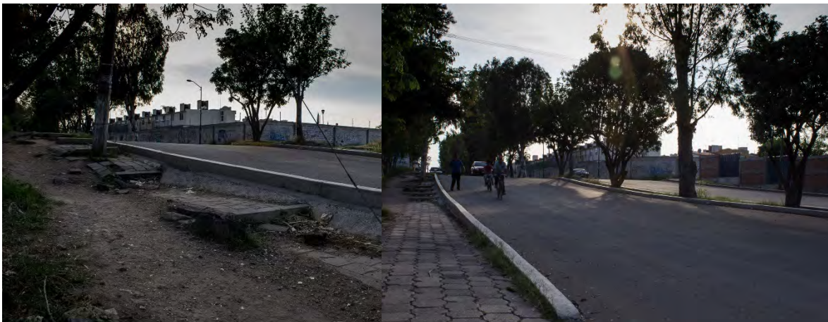
Fotografía 28 Se observa un desnivel sobre la calle Manuel Orozco y Berra donde se observa la banqueta destruida, además de una barda construida de forma escalonada.
