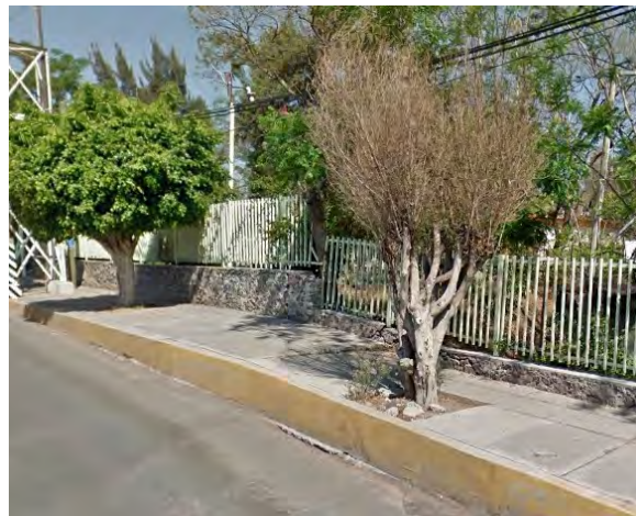
Fotografía 26 En la Av. Irrigación se observa un cambio de nivel y afectaciones sobre un enrejado, personas de Tecnológico de Celaya nos informaron que antes el terreno era una secundaria pero debido a los daños en la estructura fue cerrada.
