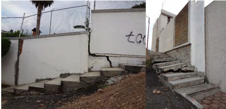
Fotografía 24 Sobre la calle Jalisco se encontraron serias afectaciones en las bardas y banquetas, y un desnivel aproximado de 1.50 m.
