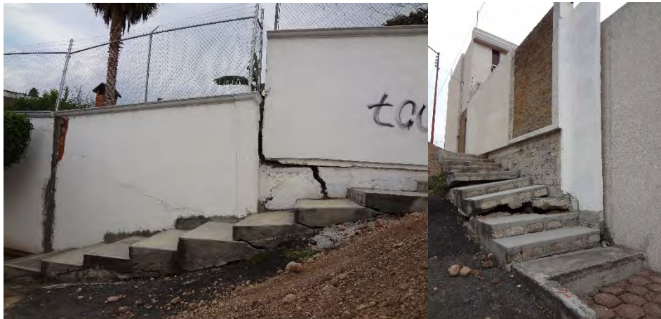
Fotografía 24 Sobre la calle Jalisco se encontraron serias afectaciones en las bardas y banquetas, y un desnivel aproximado de 1.50 m.
