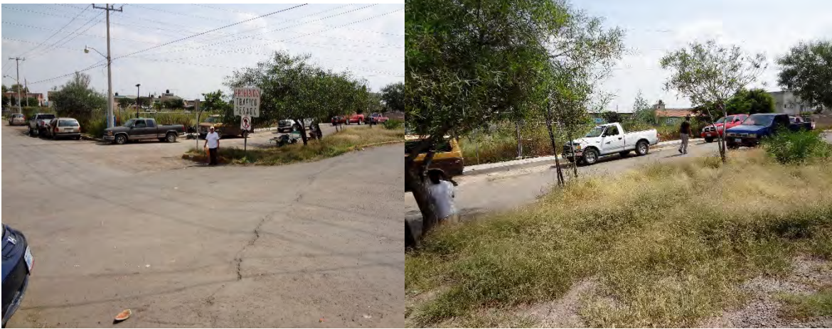
Fotografía 1 Calle Vasco de Quiroga en la parte sur de la ciudad, localizado detrás de la Central de Abastos. Se observa un claro desnivel que cruza la calle, afecta el camellón y también a la Av. Paseo del Sol.
