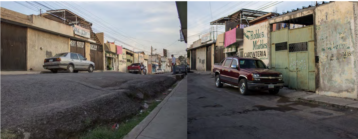
Fotografía 33 Se observa los daños sobre la calle Presa de la amistad el asfalto esta levantado del nivel de la acera de lado este de la calle y se observan daños sobre las casas en especial en la carpintería evidente en el zaguán.
