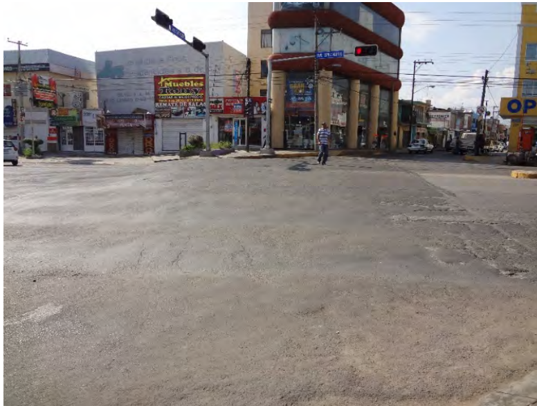
Fotografía 7 Esquina de las calles Luis Cortázar y el Blvd. Adolfo López Mateos se observa el desnivel sobre la calle, pero es más evidente entre las construcciones donde está en un nivel más alto el edificio al este y las otras casa están más abajo.
