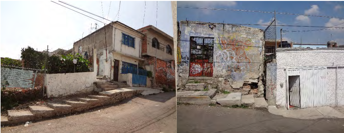
Fotografía 19 En la calle Acapulco se puede observar un desnivel de casi dos metros. Se ven al menos cuatro casas afectadas, una totalmente partida por la mitad, otra que sólo queda la barda de la construcción original y al parecer se encuentran ya deshabitadas.
