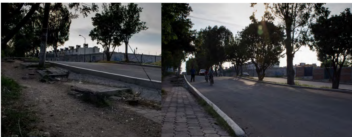
Fotografía 28 Se observa un desnivel sobre la calle Manuel Orozco y Berra donde se observa la banquetta destruida, además de una barda construida acorde al desnivel de la calle.
