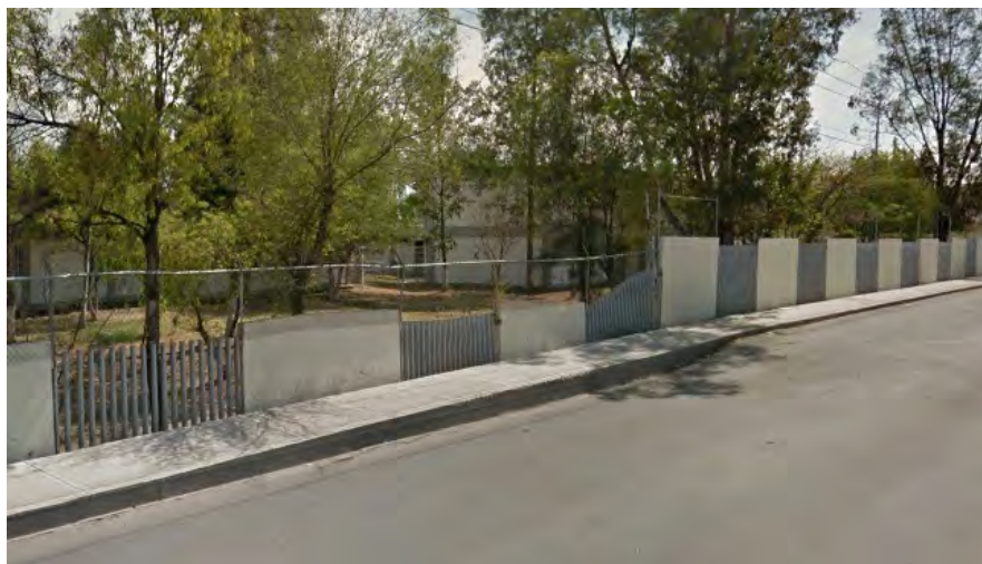
Fotografía 29 Avenida México Japón, se observa un pequeño desnivel sobre el pavimento además de daños en la barda.
