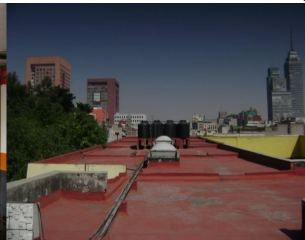
Ilustración 105 (instalaciones mercado San Juan)
