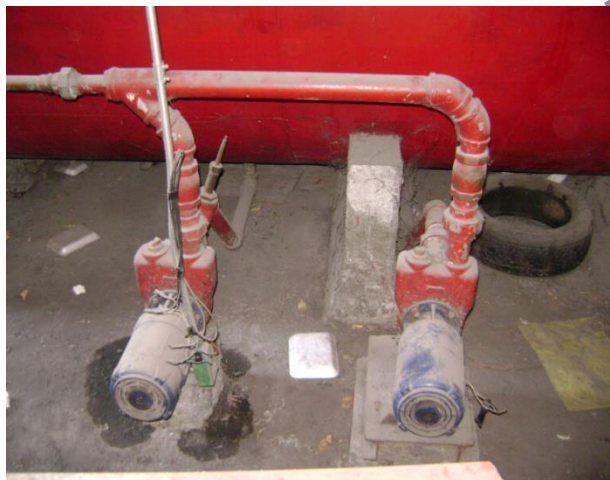
Ilustración 103 (instalaciones mercado San Juan)
