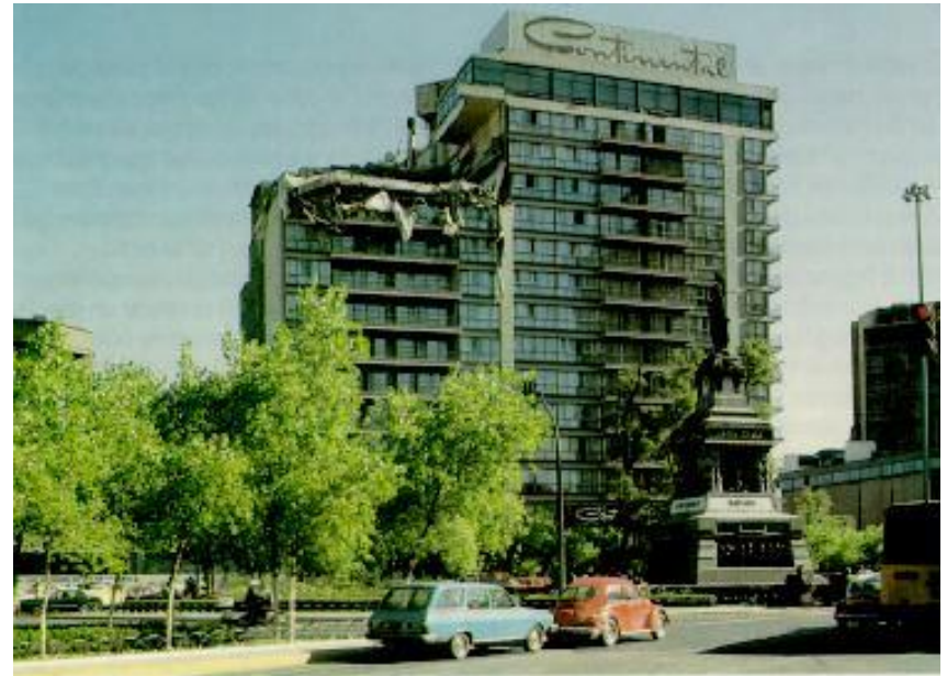
Ilustración 82 (daños sismo D.F.)
