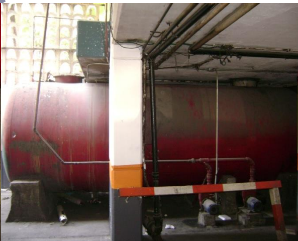
Ilustración 104 (instalaciones mercado San Juan)
