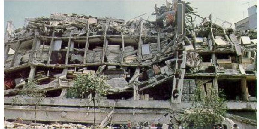
Ilustración 80 (daños sismo D.F.)
