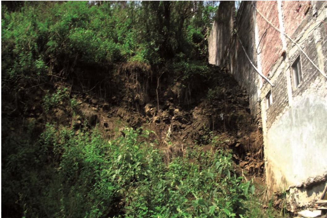
Fotografía 12. Corte a un costado de una construcción que potencializa el peligro de derrumbe en Acoca. (19.2442° N, 99.1324° W. Calle: Chocolines).
