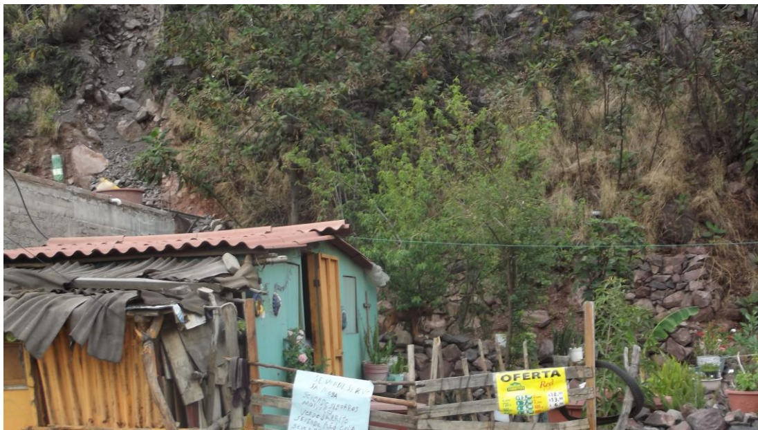
Fotografía 9. Vivienda precaria que presenta afectaciones por flujo de lodo en la parte trasera de la misma. (19.2320° N, 99.0690° W. Calle: Sin nombre oficial).
