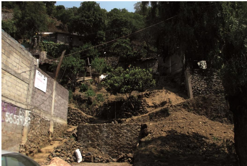
Fotografía 15. Construcciones vulnerables ante un derrumbe en el Cerro Tezontitla a pesar de contar con obras de mitigación. (19.2250° N, 99.0947° W. Calle: Camino Real a San Bartolo).
