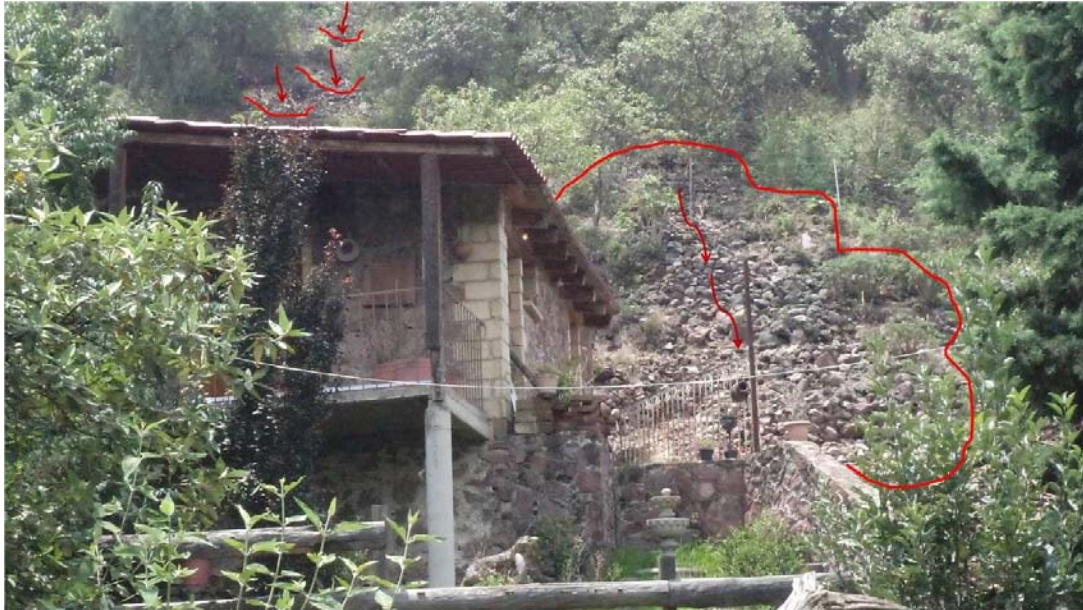
Fotografía 2. Vivienda expuesta al peligro por caída de rocas. (19.2301° N, 99.1271° W. Calle: Cerro Tetequilo).
