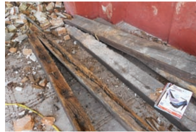
Fig.116 Vigas de madera con ataque de carcomas
