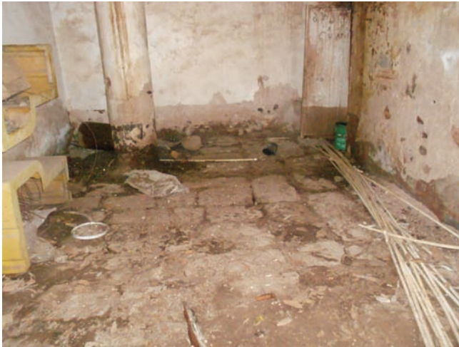
Fig. 77 El cubo de la escalera es el único espacio del mesón que aún conserva su piso original, baldosas de recinto, el piso del patio también eran del mismo material como lo indica el arquitecto Esteban González en la bitácora de obra.
