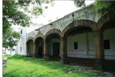
Portal de la hacienda, presenta humedades por escurrimiento de agua de lluvia.
