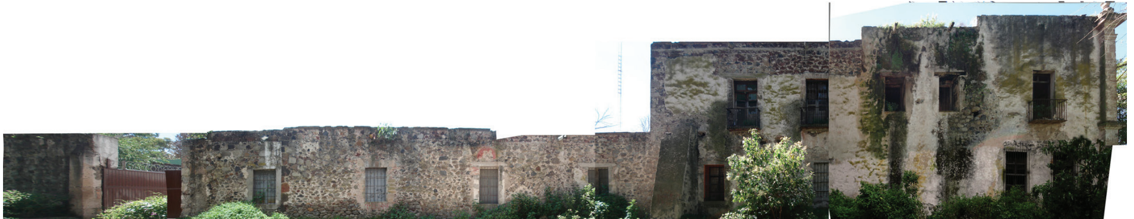
Fig.121 Humedad por capilaridad en la fachada Norponiente. La humedad por escurrimiento ha causado disgregación del aplanado de cal en la fachada norponiente. Estos vanos corresponden al cubo de la escalera.
