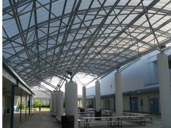
Fotografía 42. Lanik I. Patio exterior de Dillard High School. Se observa la cubierta espacial curva apoyada sobre ocho columnas circulares.
