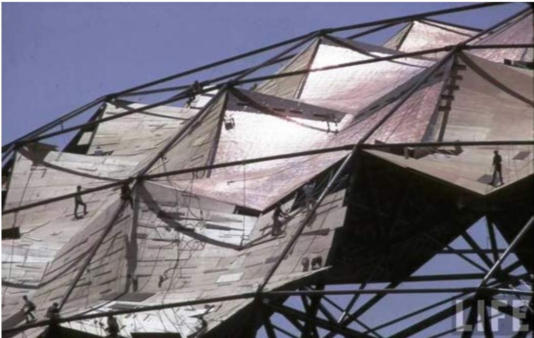
Fotografía 32. Félix Candela. Palacio de los Deportes. Ensamble de la cubierta de paraboloides sobre la estructura espacial geodésica.
