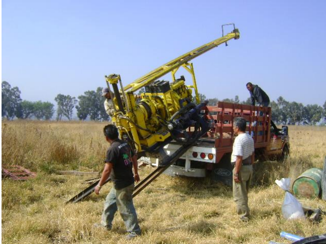
MOMENTOS EN QUE LA MAQUINA ROTATORIA LONG-YEAR ES BAJADA DEL CAMIÓN PARA SER COLOCADA EN
