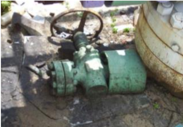
Figura 67 Salida de cabezal hundida por contracción térmica.
