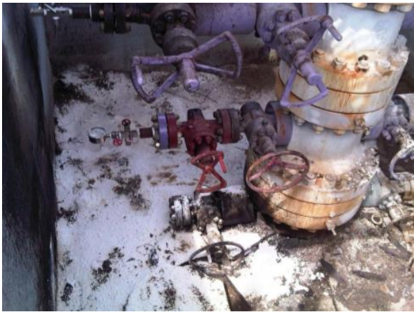
Figura 64 Cabezales hundidos por contracción térmica.
