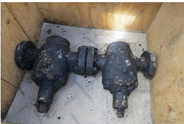
Figura 84 Válvulas laterales que fallaron
