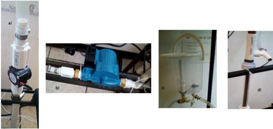
Figura 8. Componentes que forman el lazo de circulación: a) sensor de velocidad, b) bomba de agua, c) tubería de vapor hacia la turbina y de agua de alimentación, d) núcleo y sensor de temperatura a la salida
