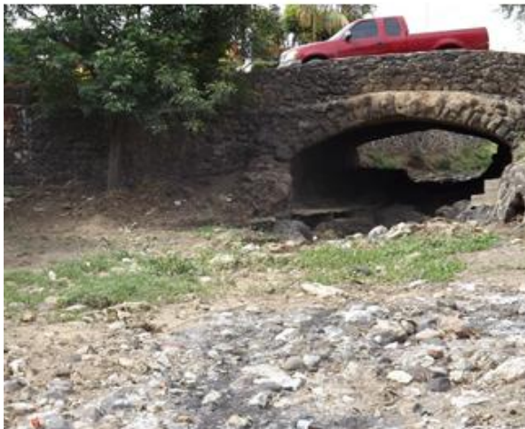
Figura 51. Vista hacia al sur. Se observa el puente por donde transitan los vehículos. Foto del autor
