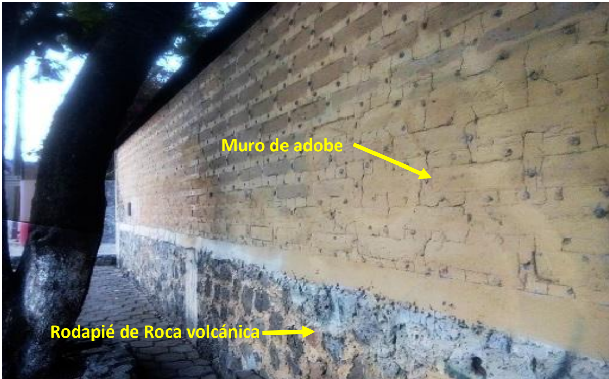
Figura 27. Casa construida con muro de adobe y rodapié de roca volcánica. Foto del autor.
