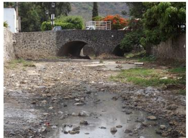
Figura 52. Vista hacia al norte. El estado del arroyo es de deterioro. Foto del autor
