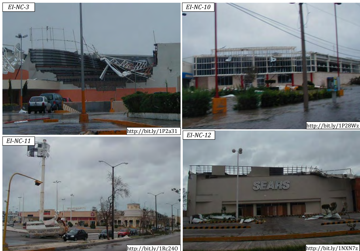
Figura 3.25. Daños en Naves Comerciales
