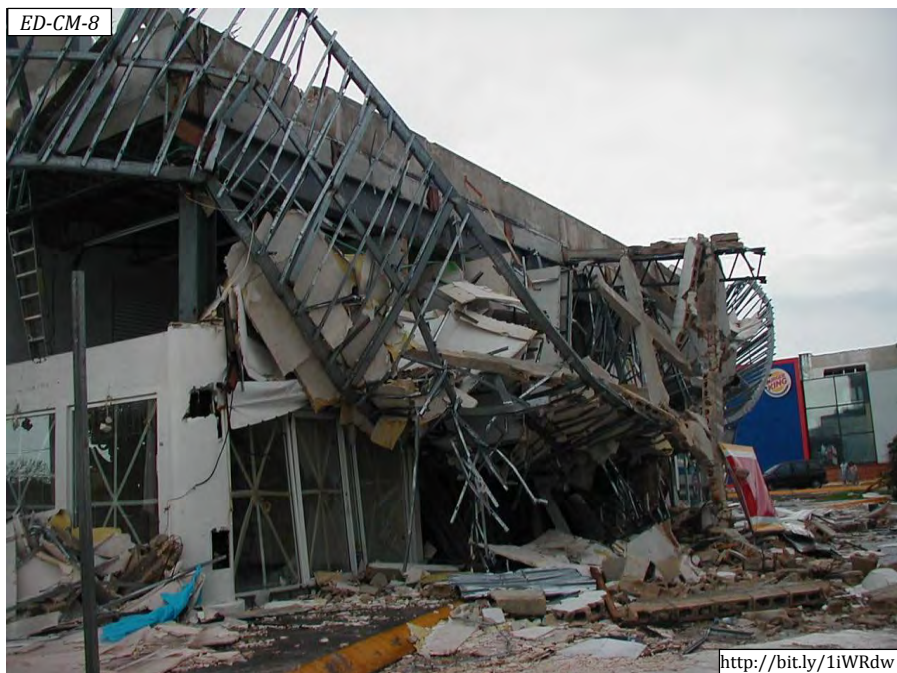
Figura 3.9. Colapso de pretil y marquesina en tienda de conveniencia
