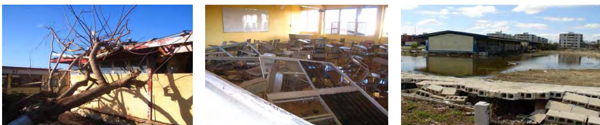
Figura 3.7. Daños en diferentes escuelas en Quintana Roo
