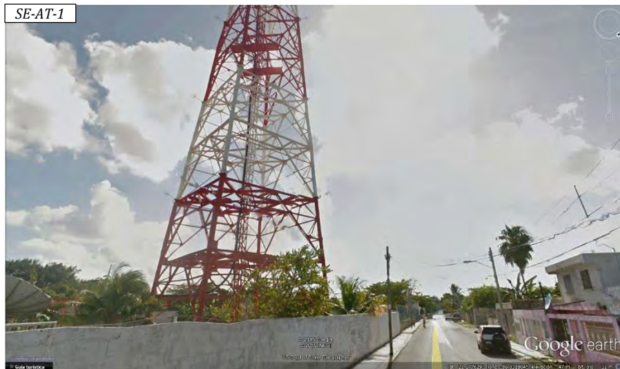
Figura 3.43. Antena repetidora en su estado actual (Google Street View 2015)
