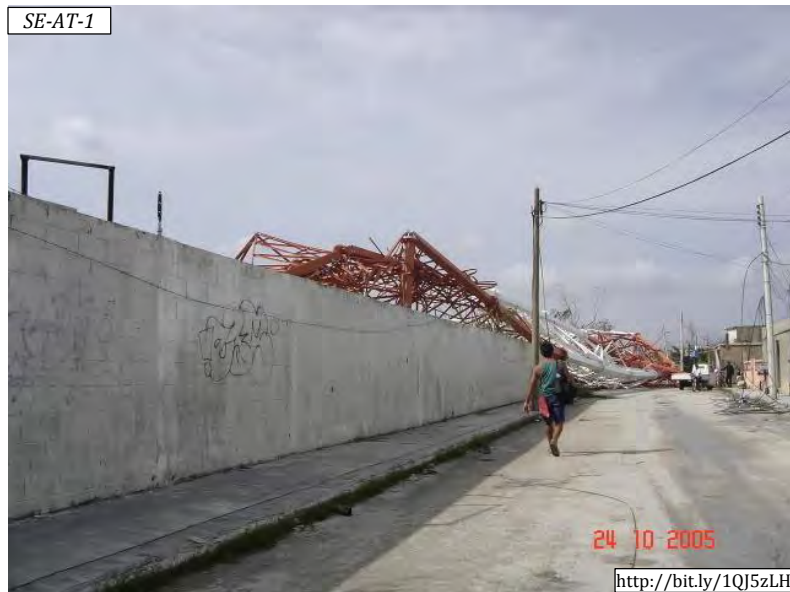
Figura 3.42. Colapso de antena repetidora de TV
