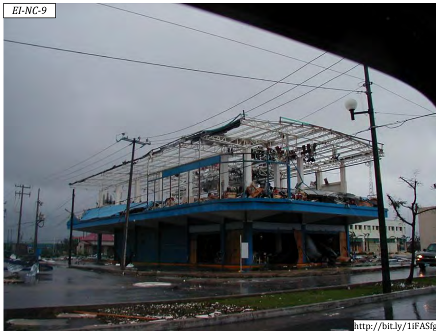
Figura 3.27. Daños en bodega de muebles
