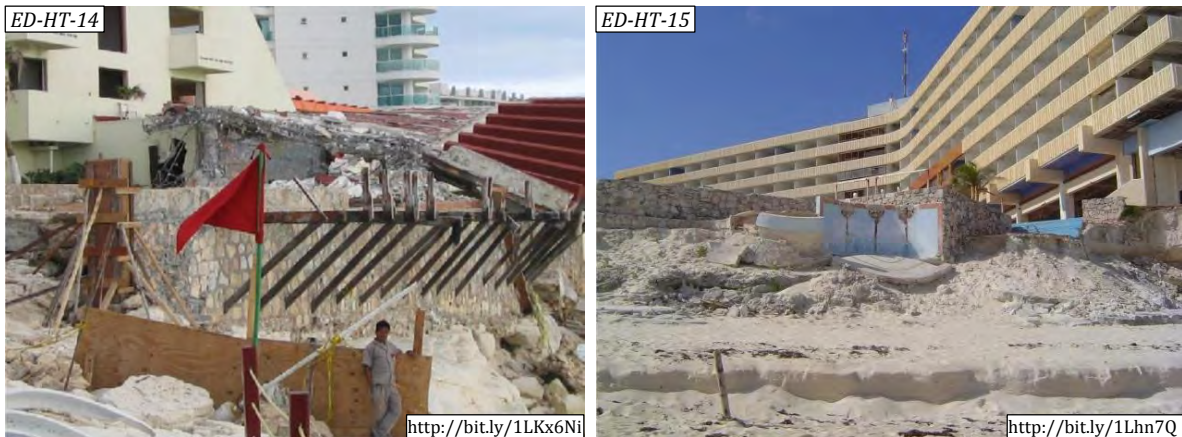
Figura 3.15. Socavación por marea de tormenta
