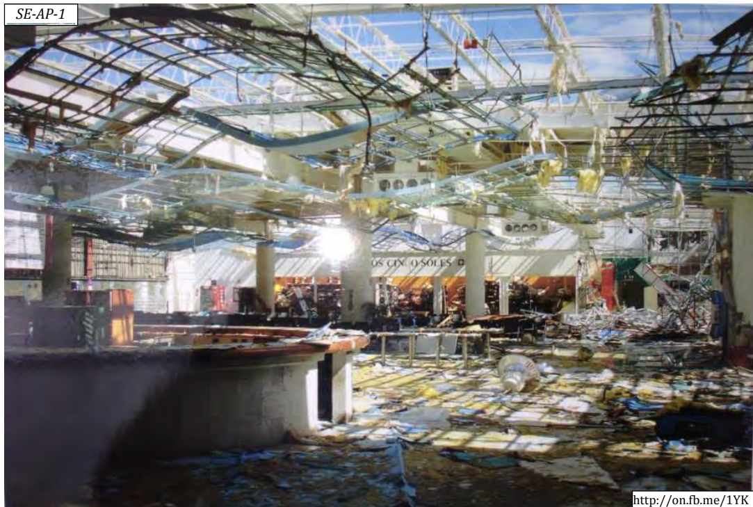
Figura 3.29. Afectaciones sala de espera del Aeropuerto Internacional de Cancún - Terminal 2.
