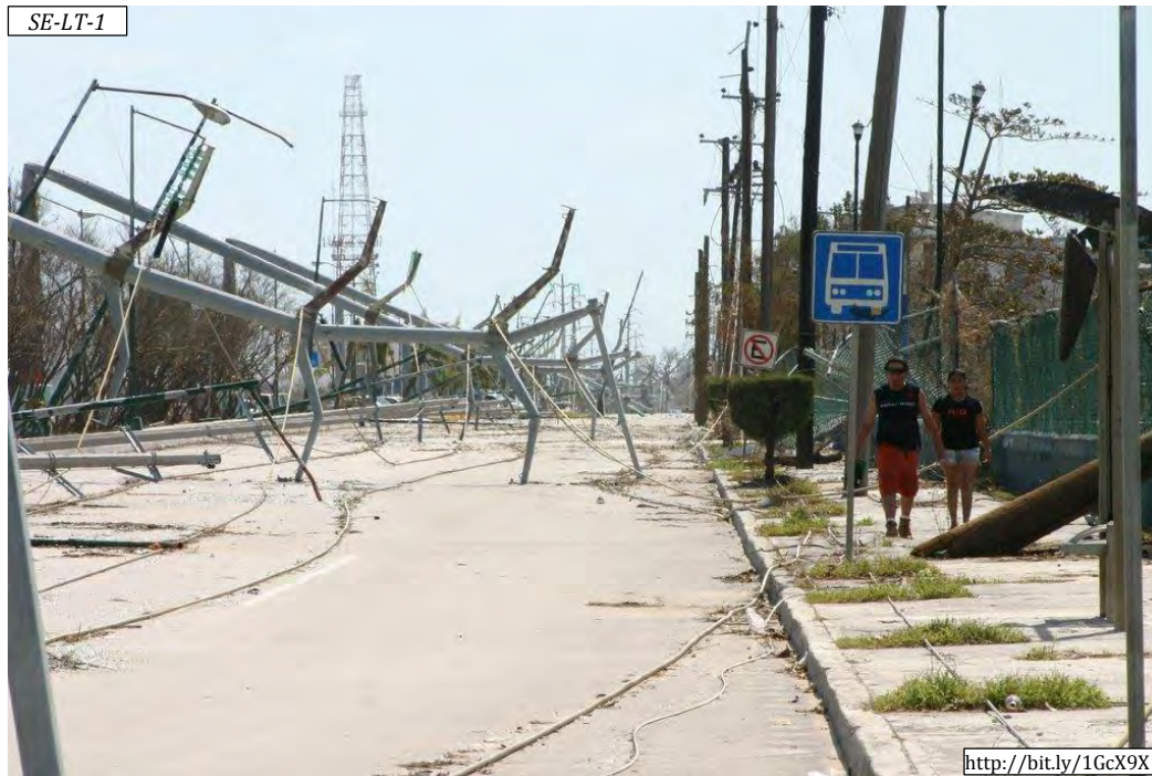
Figura 3.34. Daños por flexión en líneas de alta tensión en Av. Bonampak, Cancún.
