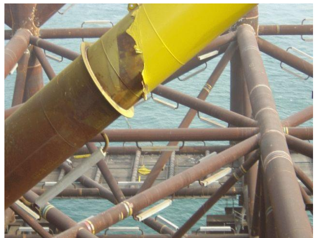
Fig. 3.12. Ejemplo de barras de ánodos de sacrificio en el Jacket de una plataforma.
