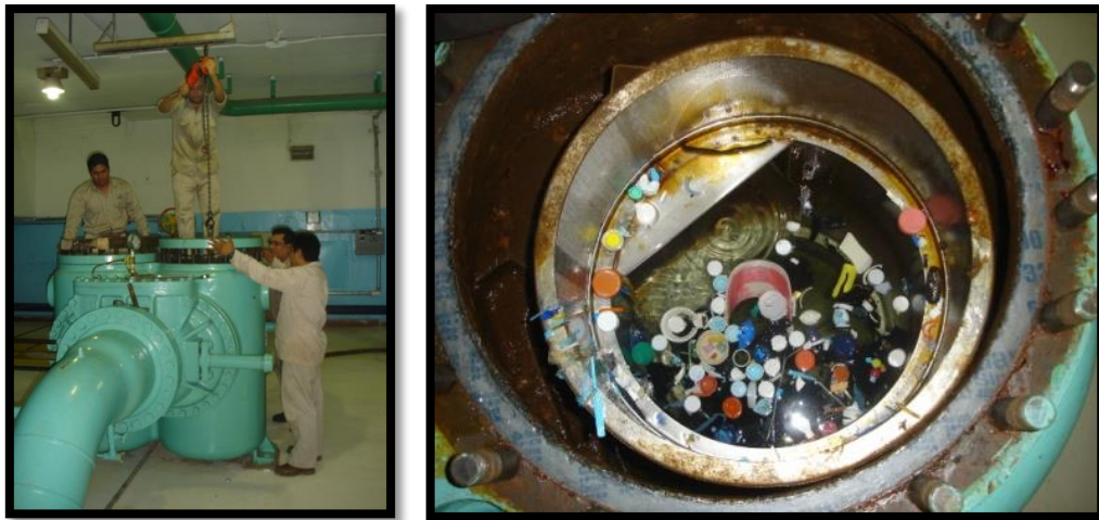
Figura 7-18. Obstrucción por tapa-roscas hacia el filtro del sistema de enfriamiento de las turbinas de la CH Chicoasén.
