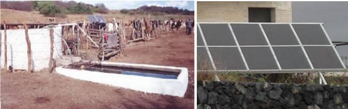
Figura 76. Bebederos y paneles solares del sistema solar de bombeo.
