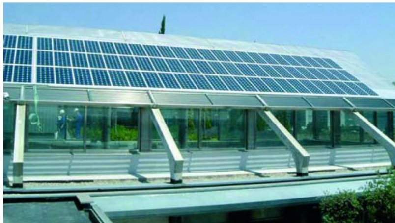
Figura 34. Paneles fotovoltaicos en la sede central de Sanitas (Madrid).
