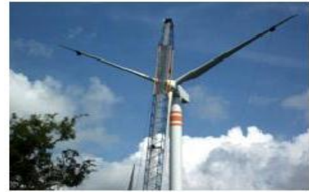
Figura 79. La Central La Venta III.
