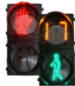
Semáforo peatonal de Leds
