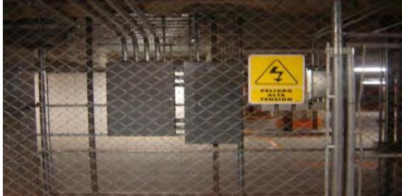
Centro de carga
