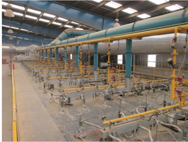
Figura 15. Inyectores de gas del horno túnel.
