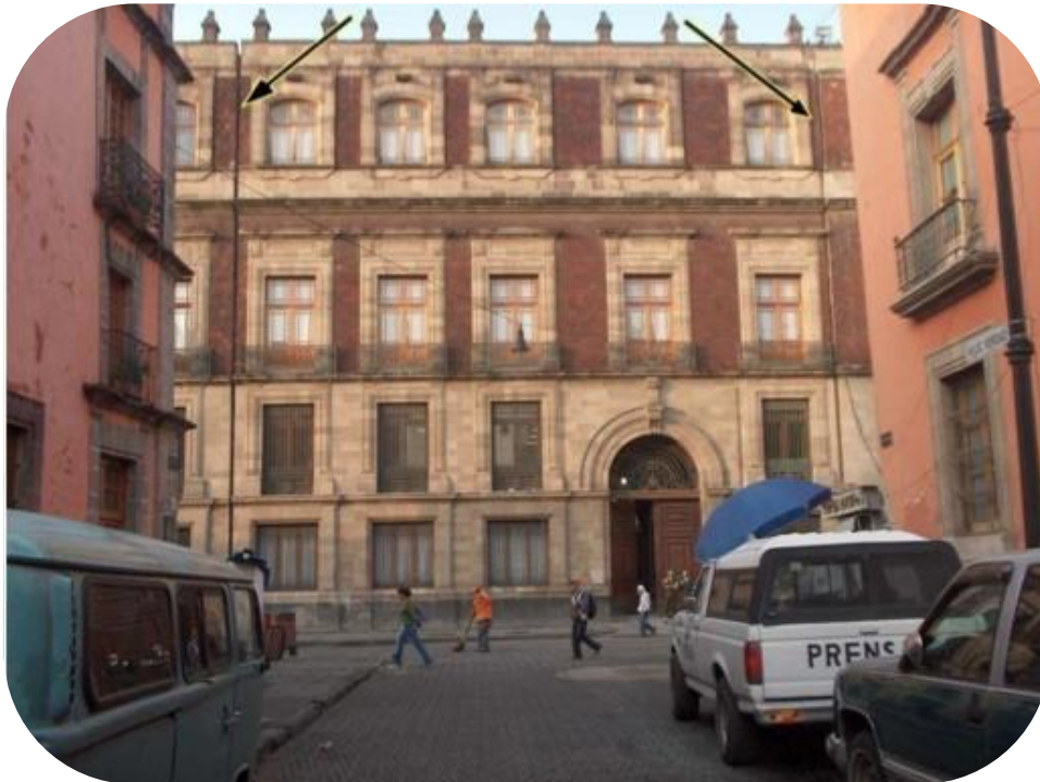
Figura (2.5) Pared norte de Palacio Nacional, las flechas indican las grietas a ambos lados de la puerta.
