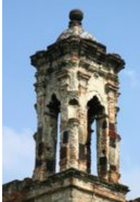
Figura 47 Estado del campanario antes y después del incendio de la capilla.
