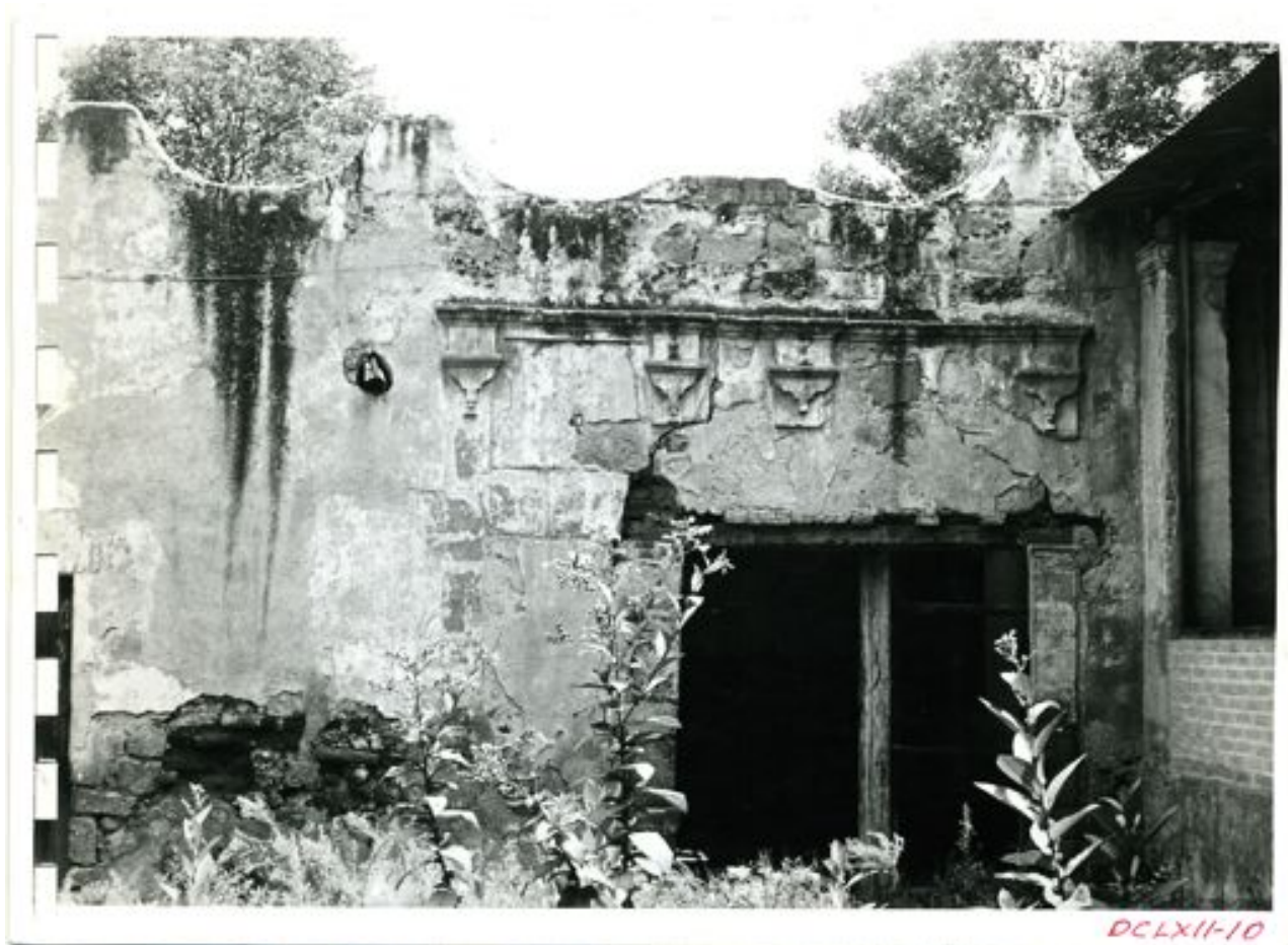
Figura 60 Edificio apuntalado. Ala sur.
