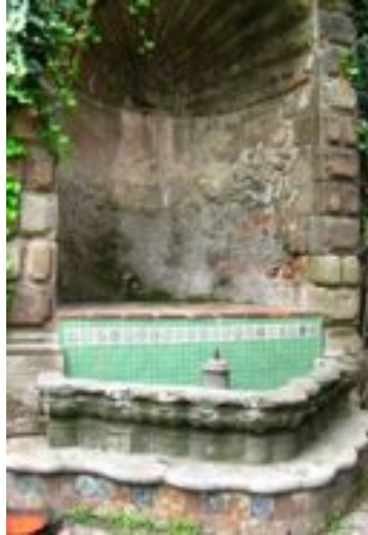
Figura 50 Pila de agua o fuente.
