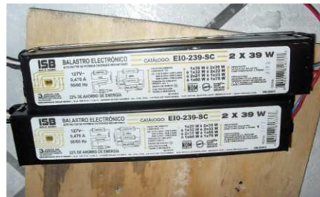
Figura 1-17 Balastos utilizados en caso base
