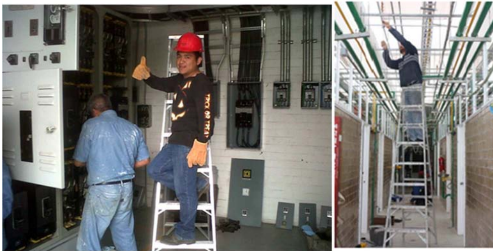
Figura 3-1 Levantamiento eléctrico en las instalaciones
