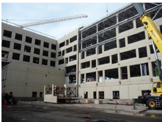
Figura 2.1 Instalación de paneles prefabricados de concreto en un sistema estructural (Hutchinson et al., 2014).
