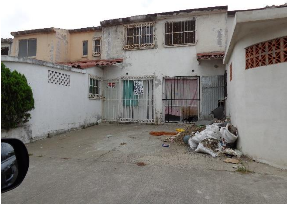
Figura 34 Viviendas en abandono. Fuente: elaboración propia 10 Junio 2015
