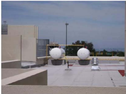
Arriba: Suministro de Datos.. Abajo: Azotea. Tanques de gas..
