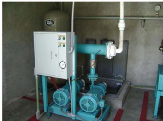
Arriba: Área de Gases, Cuarto de Maquinas. Abajo: Área de bombas, Cuarto de Maquinas.
