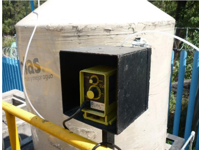
Figura 6.7. Sistema de cloración de la planta de tratamiento Nativitas, el cual consta de un tanque ROTOPLAS® y un dosificador eléctrico.
