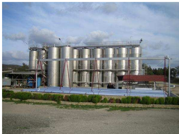
Figura 2.2 Refrigeración industrial proyecto MEDISCO
