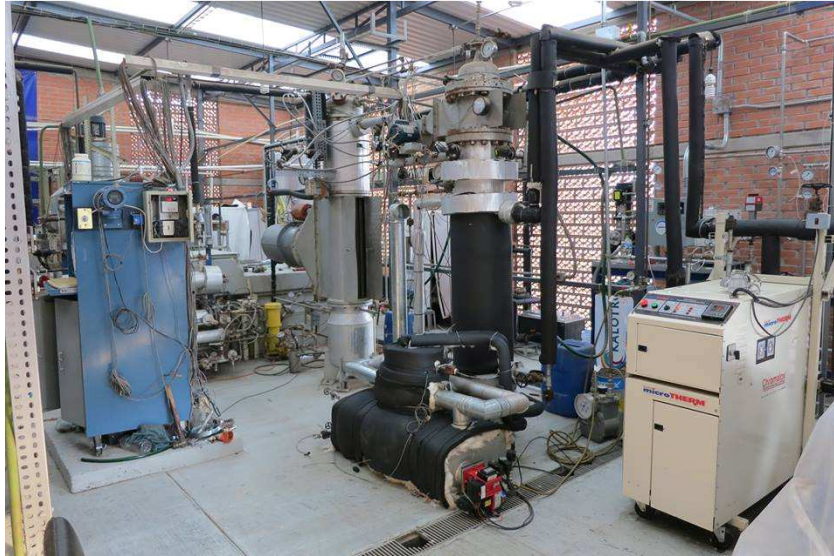
Figura 4.12 Generador a fuego directo acoplado al sistema de refrigeración por absorción avanzado Solar- GAX-LP.
