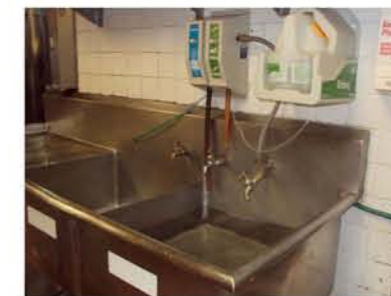
Imagen de la zona de lavado, las tarjas y los desinfectantes.
