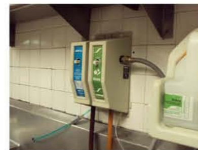
Los desinfectantes se encuentran en la pared y tienen entrada directa de agua.
