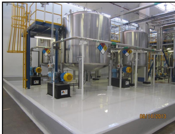
Figura 2.12 Tanques de almacenaje de base blanca.
