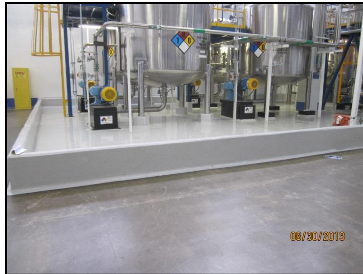
Figura 2.21 Dique contenedor de líquidos.
