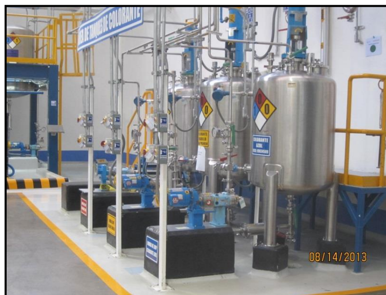
Figura 2.14 Tanques de colorantes del proyecto MIDAS.
