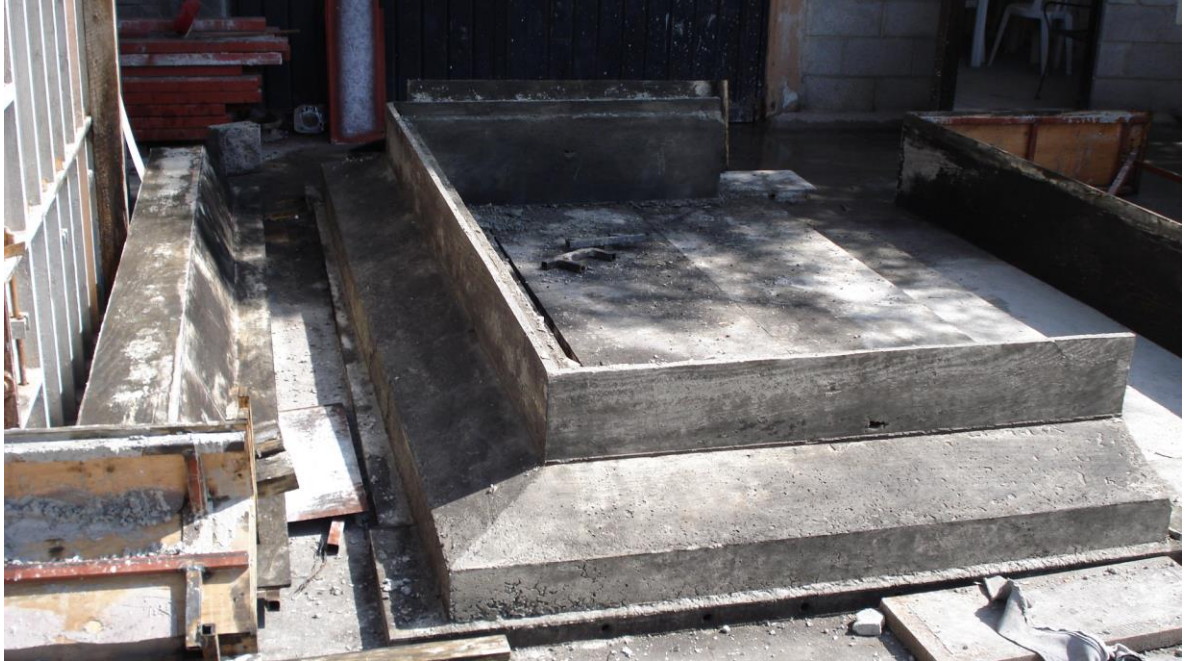
Figura 27, Pieza1 zapata de cimentación de caja de infiltración prefabricada Fuente: propia Referencia: plano 2-A
