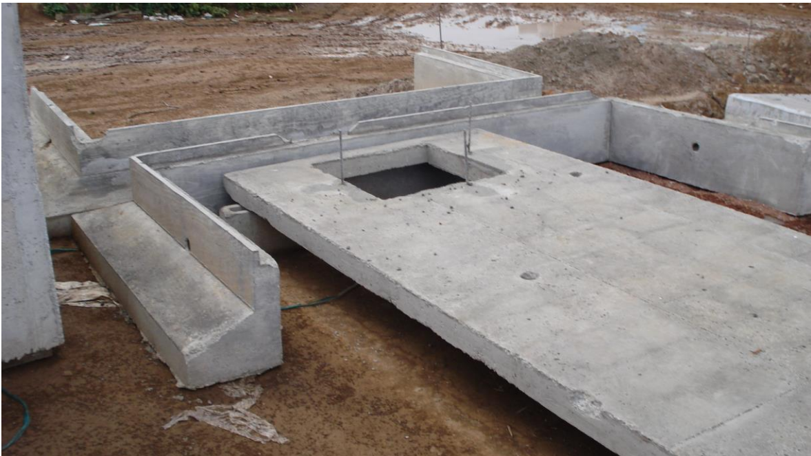
Figura 24, entrega de piezas prefabricadas en sitio de obra para su instalación. Fuente: propia
