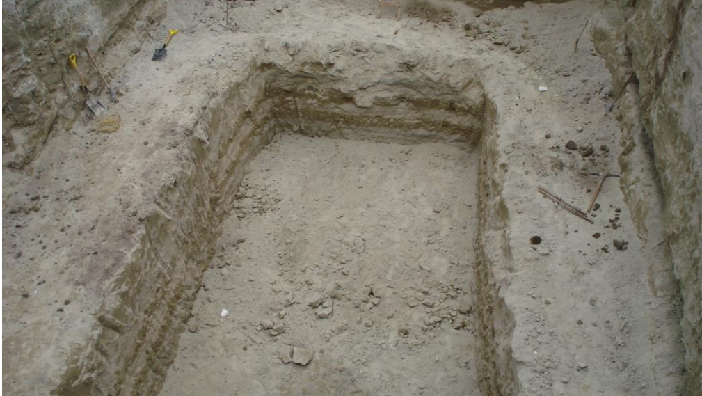
Figura 19, excavación para de caja de infiltración prefabricada Fuente: propia Referencia: plano 1-A
