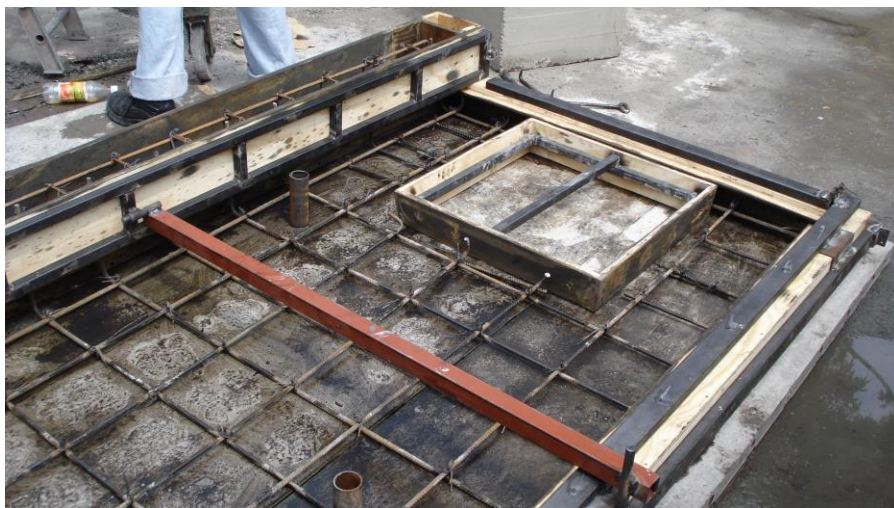
Figura 17, Armado de acero y cimbra para un vaciado monolítico de Pieza3 Losa tapa Fuente: propia Referencia: plano E-1
