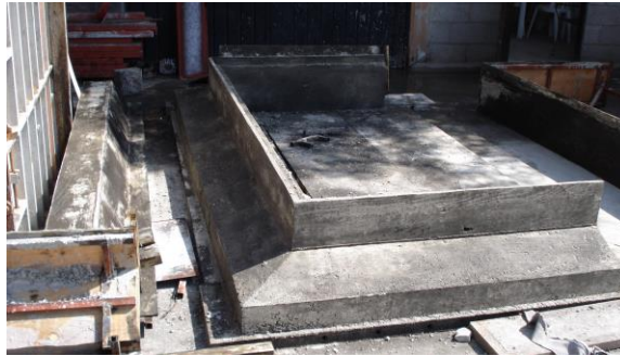
Figura 4, Elemento de Caja de infiltración, (zapata de cimentación para base de caja de infiltración prefabricado) Fuente: propia Referencia: plano 2-A
