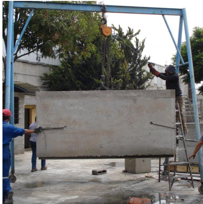
Figura 8, prefabricado Pieza2 anillo de caja de infiltración prefabricada, traspaleo para zona de embarque Fuente: propia, Referencia: plano 2-A
