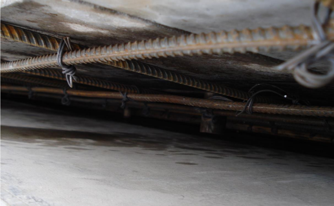
Figura 15, acero de refuerzo en pieza2 anillo de caja de infiltración prefabricada Fuente: propia Referencia: plano E-1
