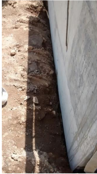
Figura 32, anillo de caja ya montado y enterrados de la caja de infiltración prefabricada Fuente: propia Referencia: plano 2-A
