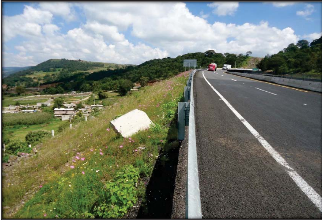
Sitio excavado para el PCA en el KM 153+000 Área de talud del cuerpo existente
