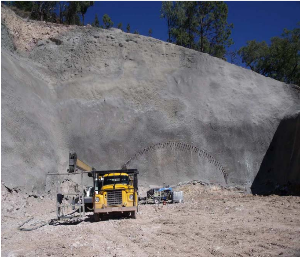
Fig. 2.3.1 Construcción de un portal, en donde se aprecia el talud frontal y el trazo de la sección superior del túnel.
