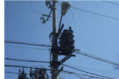
Transformador sobre la calle Coporo orientación sur
