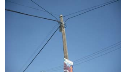
Poste del servicio de alumbrado sobre la calle Coporo orientación sur
