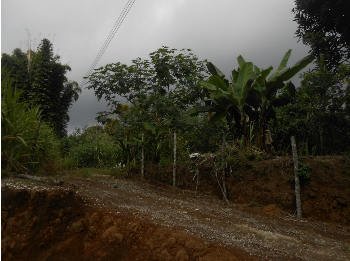
Fotografía 5 Cadenamiento 0+040 de la línea de distribución.
