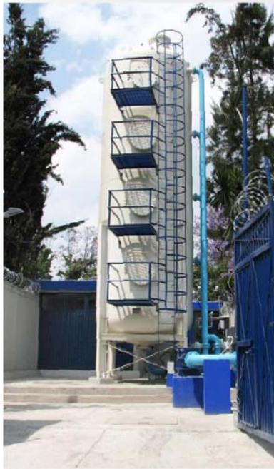
Figura 3.70 Torre de filtros a presión
