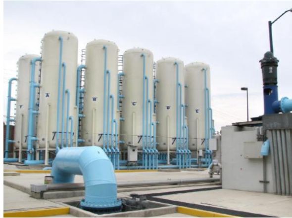
Figura 3.88 Instalaciones PP La Caldera FUENTE: Recuperado del portal ISSUU, presentación “La Caldera”, http://issuu.com/iemasee/docs/presentacion_caldera
