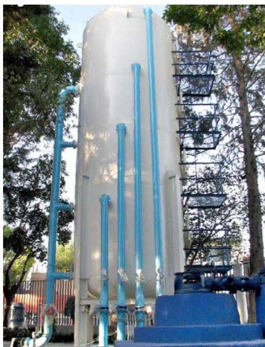
Figura 3.13 Filtro a presión de la PP Trabajadores del Hierro. FUENTE: Recuperado del portal ISSUU, presentación “Trabajadores del Hierro”, http://issuu.com/iemasee/docs/presentacion_trabajadoreshierro
