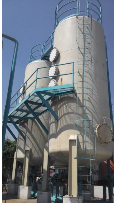
Figura 3.56 Contenedores destinados a la filtración por zeolita
