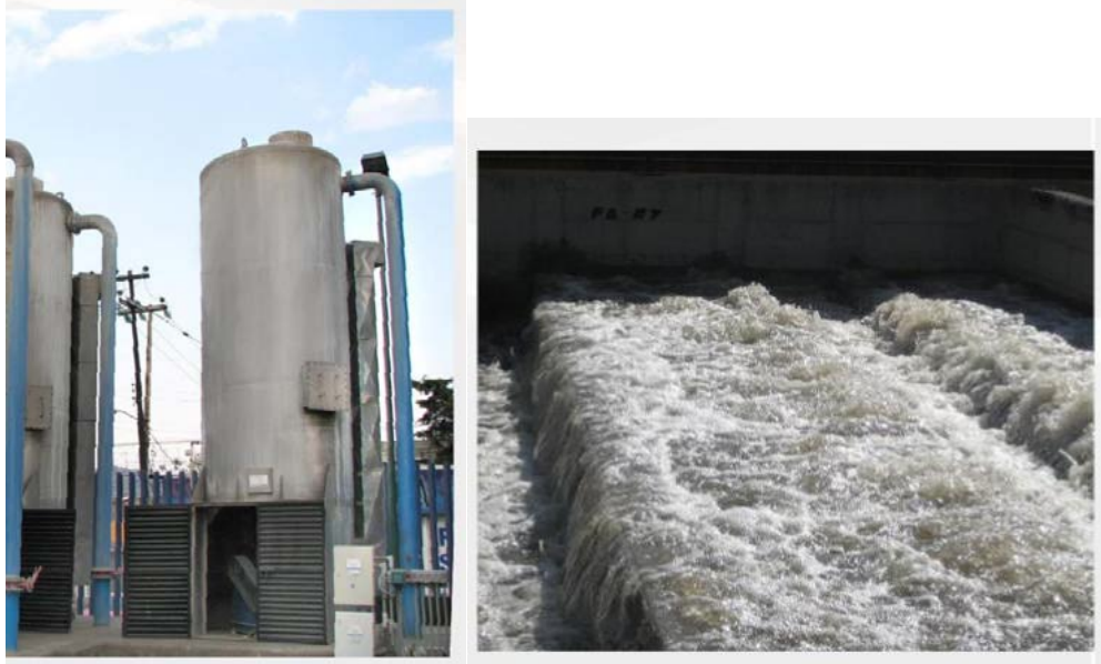
Figuras 3.16-3.17 Del lado izquierdo se presenta una de las torres desgasificadoras de la potabilizadora, en el lado derecho se muestra la unidad de biofiltración FUENTE: Recuperado del portal ISSUU, presentación “Acueducto Sierra Santa Catarina”, http://issuu.com/iemasee/docs/presentacion_santacatarina
