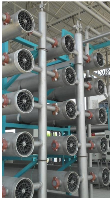
Figura 3.57 Tubos de presión
