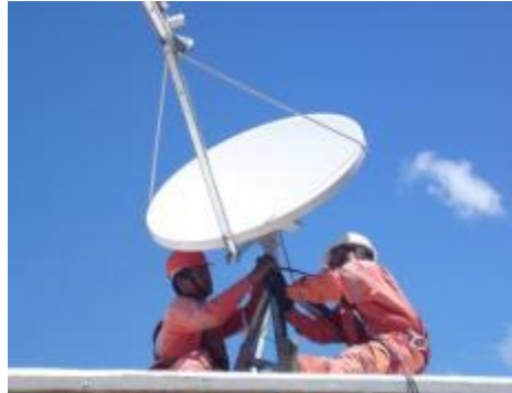
Figura 12. Sistema de telecomunicaciones
