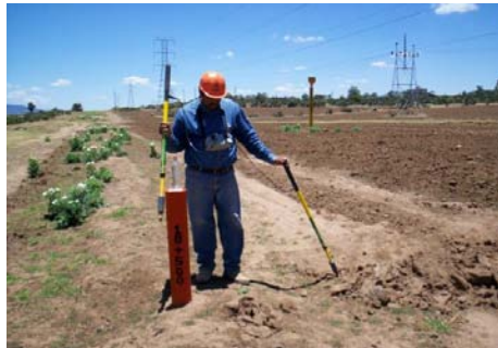
Figura 7. Postes de señalamiento y toma de potenciales
