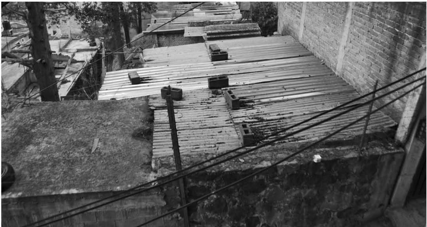
Fotografía: Entorno construido en San Salvador Cuauhtenco no.8 Nombre: “Tabiques en el techo”
