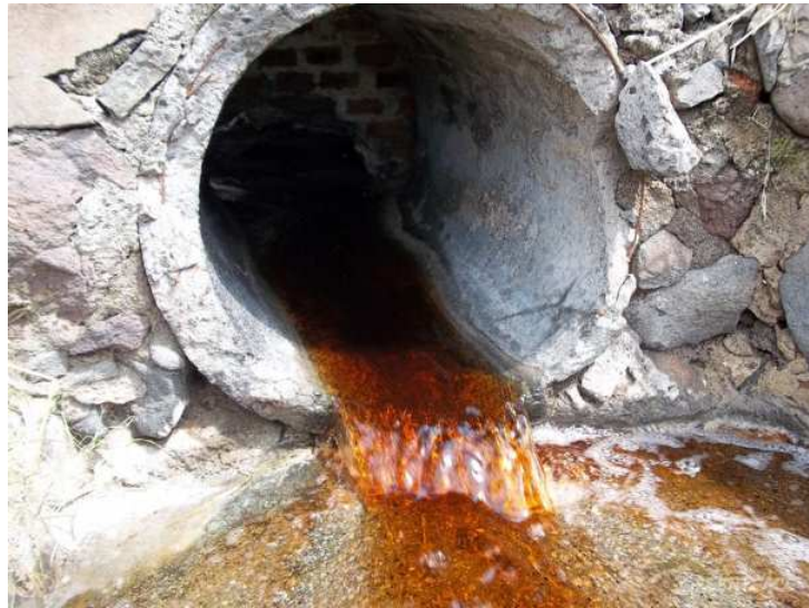
Figura 1.1: Aguas Industriales. Río Santiago, Jal. México. [11].
