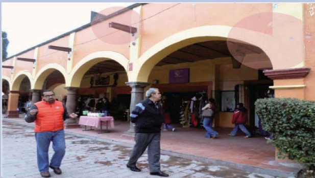
Deterioro en acabados de la Plaza Hidalgo
